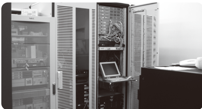
庁舎内電算機械室
