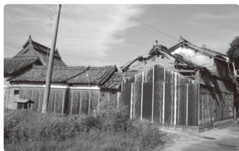
調整区域内の荒廃した家屋
