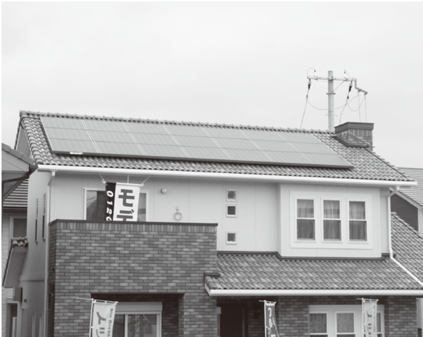
住宅に設置された太陽光発電設備
