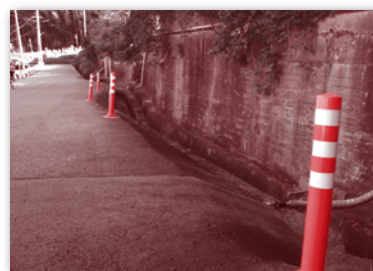
マックスバリュ太子東店南側道路の側溝
