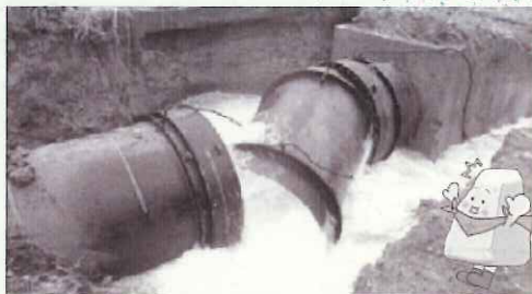
▲老朽管の破損
