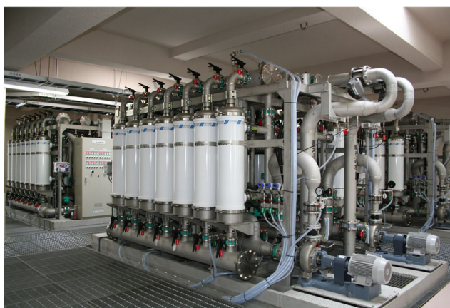
■ 老原浄水場（膜ろ過装置） ■
