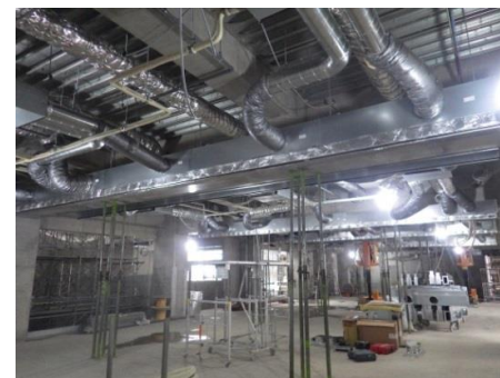
天井設備配管
