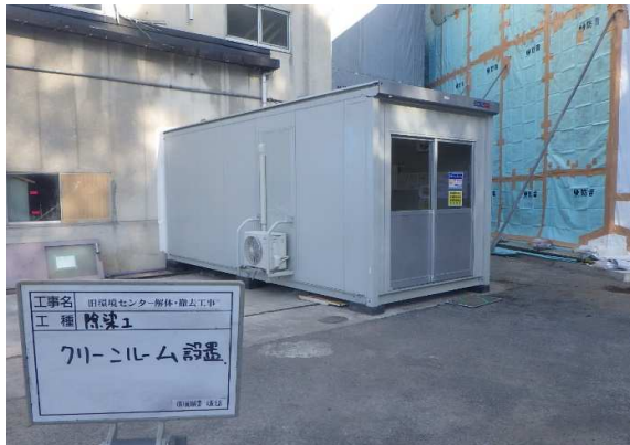
クリーンルーム設置状況
